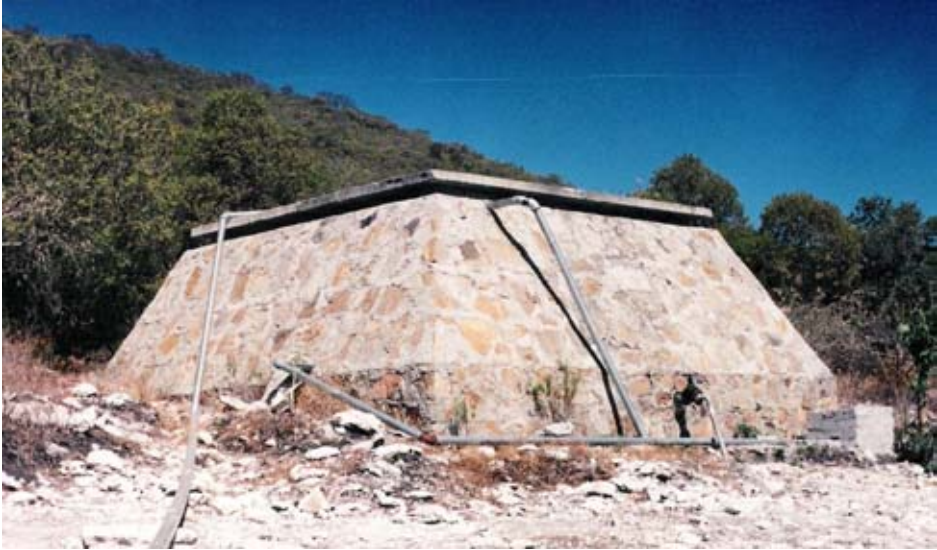
Uno de los depósitos del agua del pueblo
