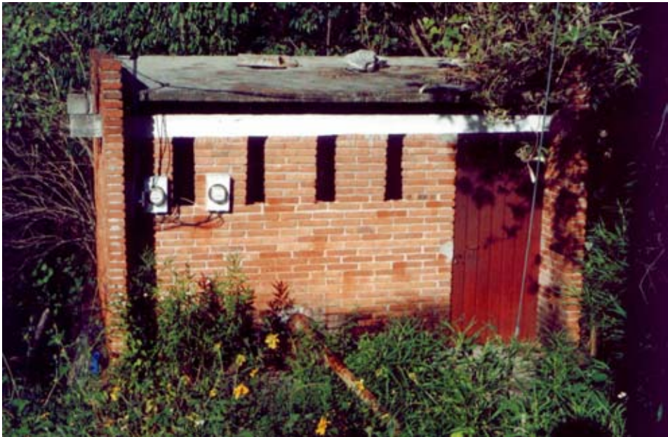
Cuarto de la bomba del pueblo
